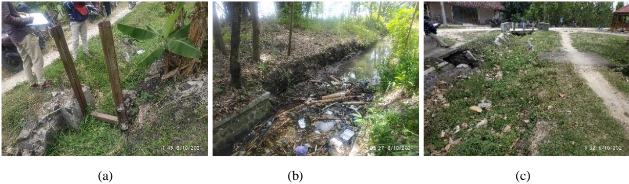
(a) (b) (c) Sumber : Dokumen Pribadi Gambar 2. Permasalahan Jaringan Irigasi Waduk Pondok
