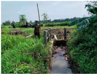
Gambar 1. Kondisi Pipa Pralon (Talang) Irigasi DI Ngarum
